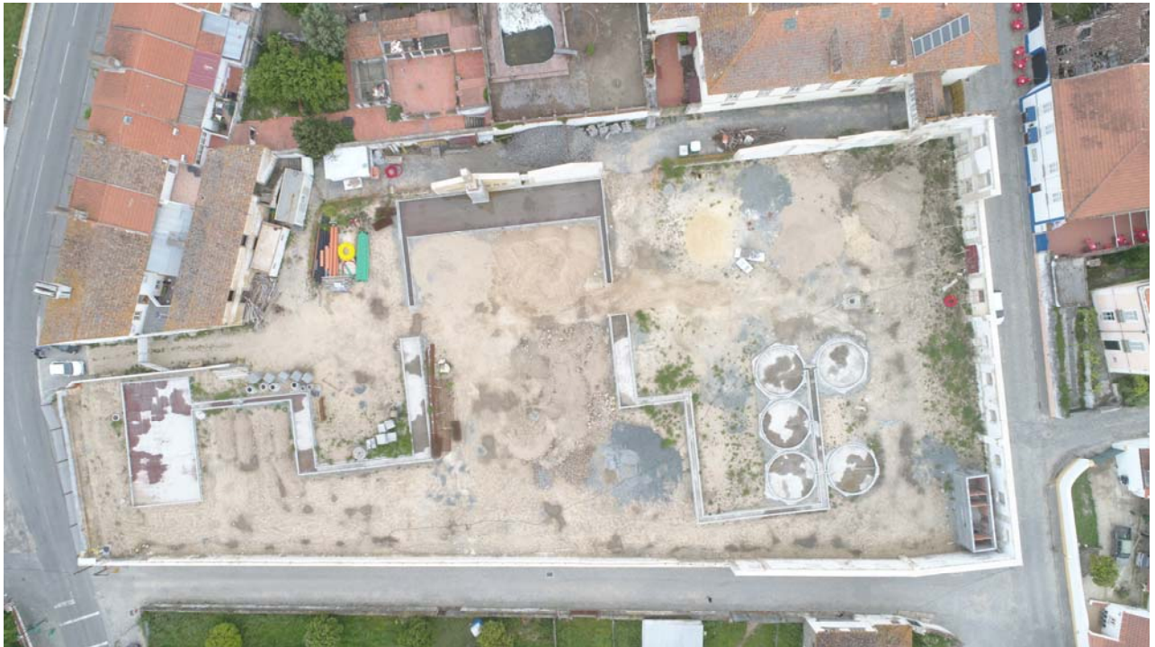
Figura 3 – Vista Panorâmica da Intervenção
