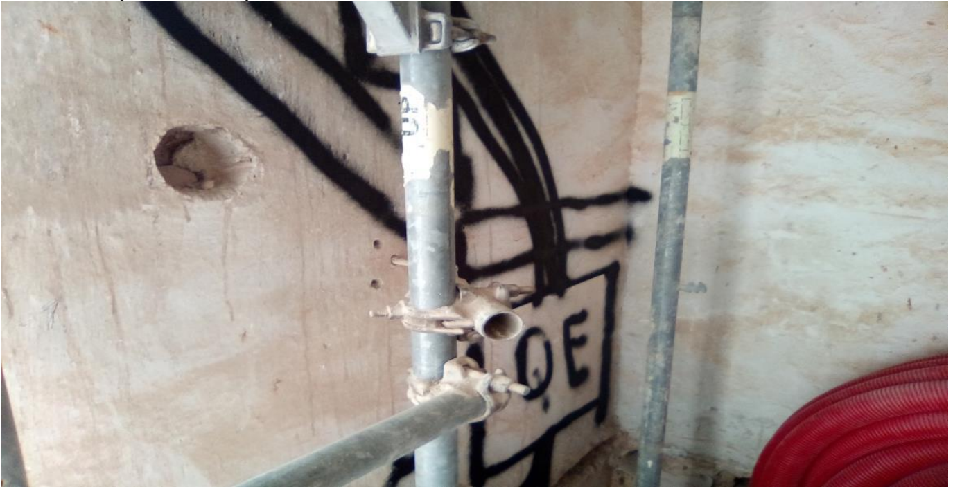
Foto 4: Marcações de instalações elétricas
